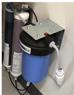
House DI water system
